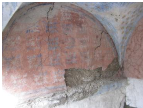
L'interno in cattive condizioni
